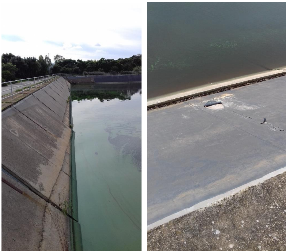
Figura 7. Vasca di Capo Comino. Dettaglio cedimenti rivestimento CLS armato e rotture manto PVC esistente
